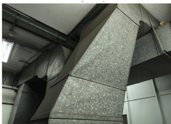
Sistema de Inyección y Extracción de Aire
